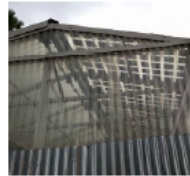
Fotografía de los paneles fotovoltaicos en la construcción existente
